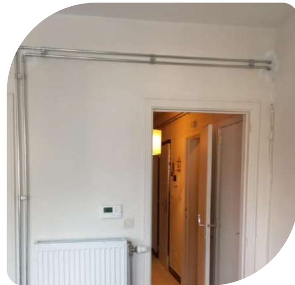
Nouveaux radiateurs Nouveaux tuyaux de chauffage
