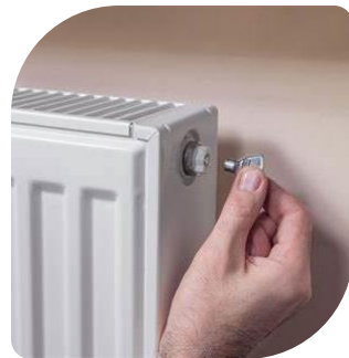
Au niveau des radiateurs
